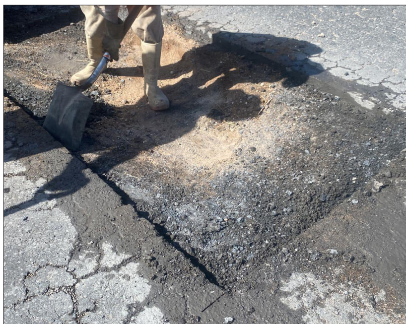
▲ A través de sus redes sociales, el presidente municipal de Fresnillo, Javier “Javo” Torres, informó que el Ayuntamiento continúa con los trabajos del programa de bacheo en atención a las quejas de la ciudadanía y con el objetivo de mejorar las calles, “es un paso hacia un mejor municipio”, afirmó agradeciendo el apoyo y la paciencia de los fresnillenses. Foto: Archivo/ Ayuntamiento de Fresnillo
