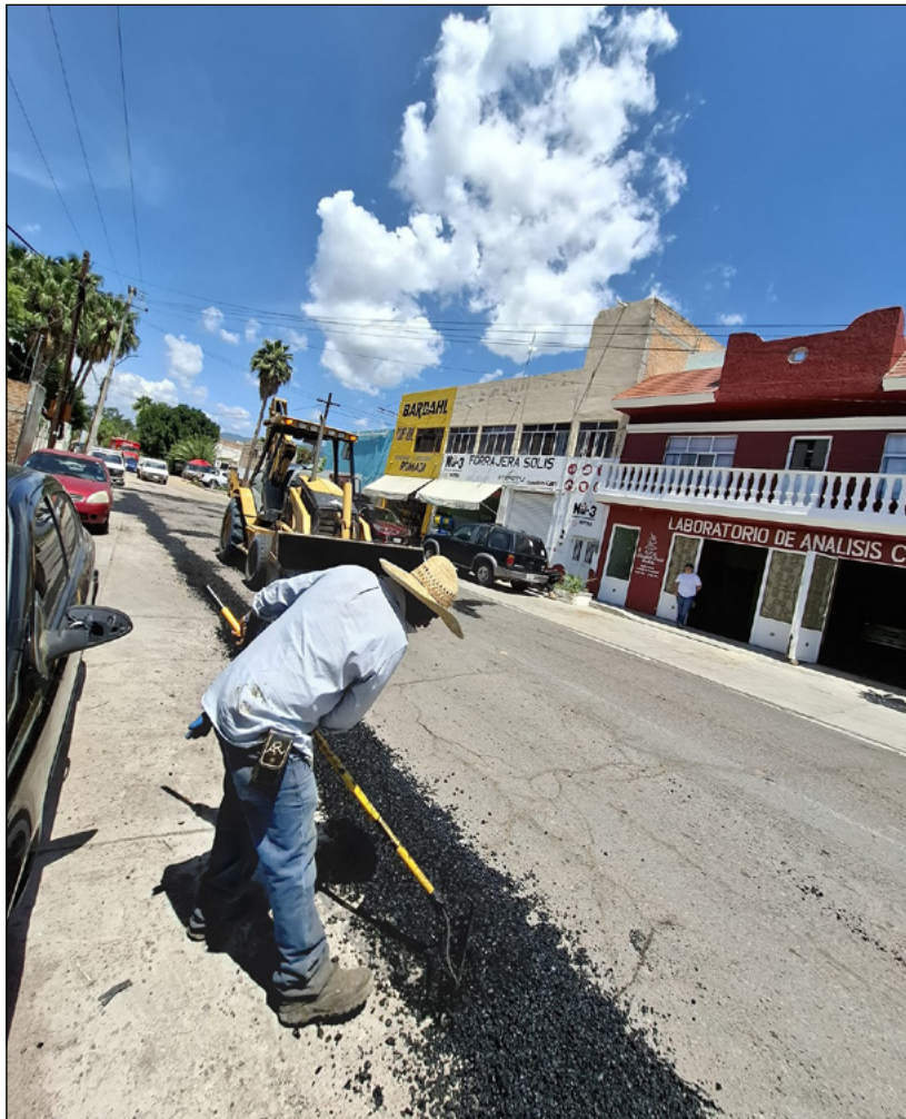
TABASCO. Personal de la Dirección Municipal de Obras y Servicios Públicos de Ayuntamiento de Tabasco continúa con las labores de bacheo en todo el acceso sur de la cabecera municipal, al igual que con trabajos de reencarpetamiento en el bulevar del acceso norte. ■ FOTO: CORTESÍA
